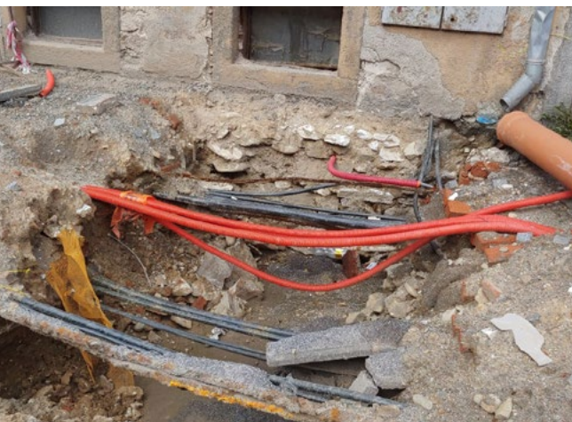
◀ Běžný příklad zaplnění chodníku kabelovými trasami
